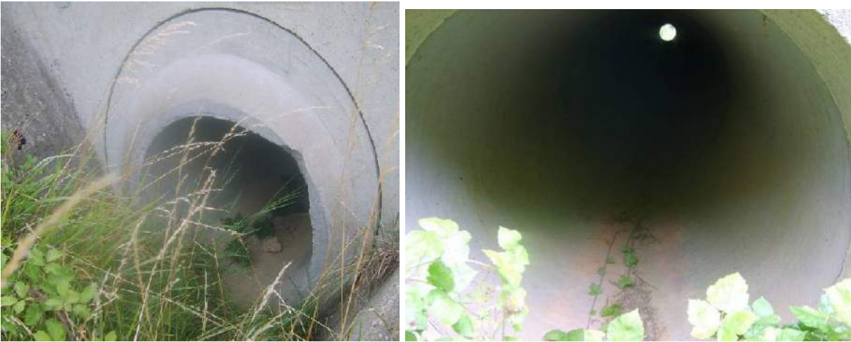
Photographie 139 et Photographie 140 : Exemple de buses sèches (vues extérieure et intérieure) © Egis / I.GEST – juillet 2011
