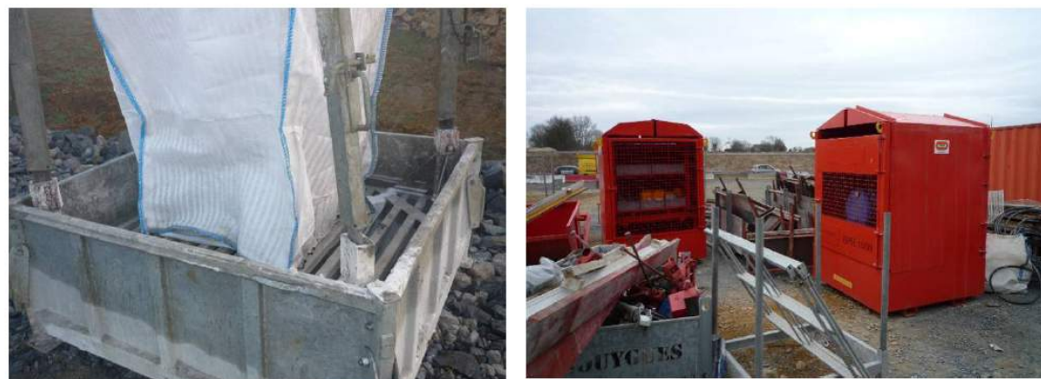
Figure 111 : Système de lavage des goulottes des toupies béton dans un big-bag (à gauche) et système de stockage de produits polluants (à droite) - Source Egis / Virginie FERRET
