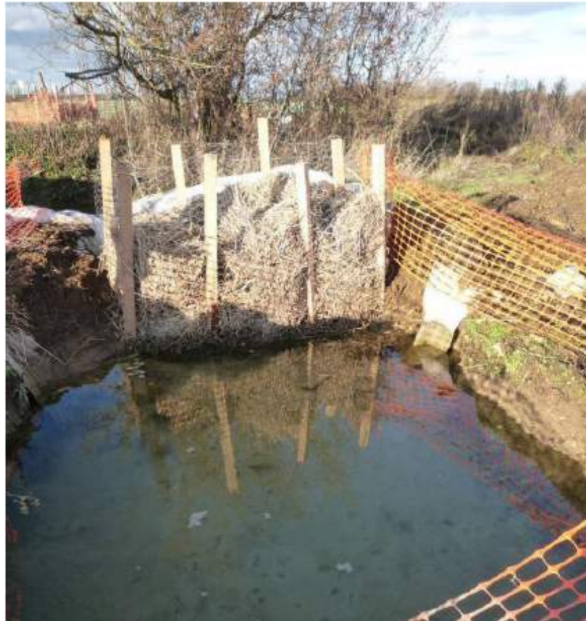
Figure 112 : Filtre à paille en sortie d'un bassin de décantation (Source : EGIS / Virginie FERRET)
