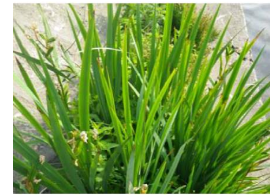
Figure 57 : Iris observée sur le parement - source : BIEF 2011
