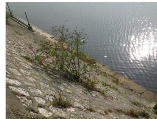
Figure 56 : arbre à papillon observé sur le parement - source : BIEF 2011
